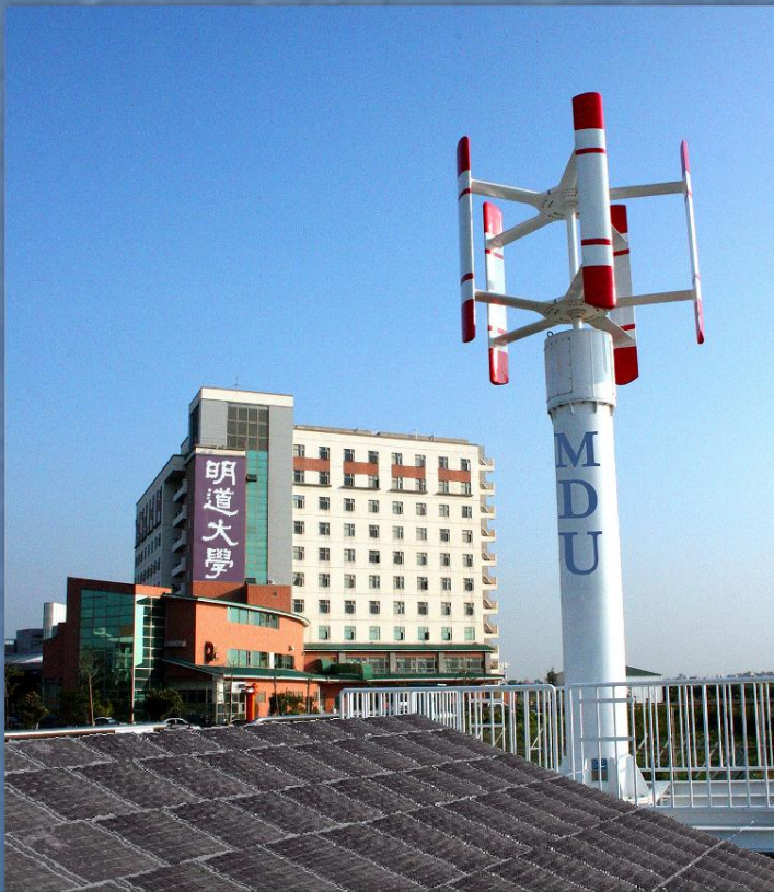
明道大學垂直軸 2kW 風力發電機
